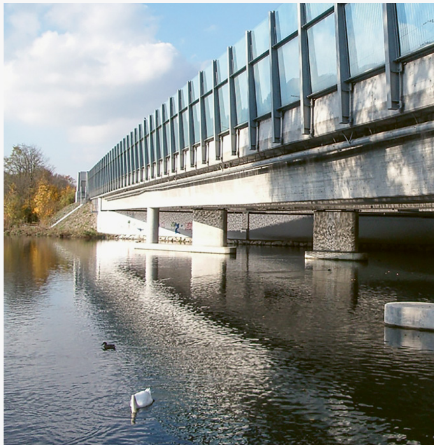
Schlichte Bezeichnung – grosse Bedeutung: 130 000 Autos befahren die Limmatbrücke N1-520 bei Würenlos täglich.
